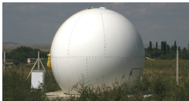
Une des deux antennes MEOLUT installées à Ankara, en Turquie, en août 2010. La MEOLUT turc fait partie d'un réseau de cinq terminaux présents dans cinq pays et sur quatre continents – un réseau qui inclut à ce jour un total de quinze antennes MEOSAR.
